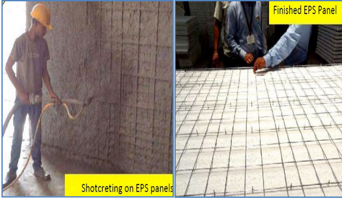
الشكل رقم (7) كيفية تثبيت مادة العزل الحراري البوليسترين المقوي بالشبكة المعدنية علي الحائط [5]
